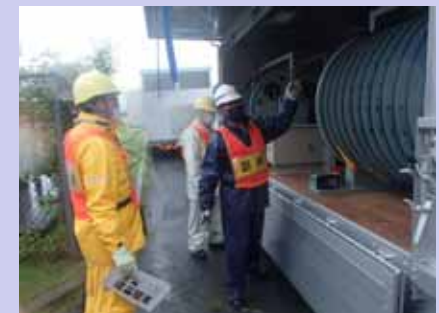
降雨時の電源車の設置・運用
