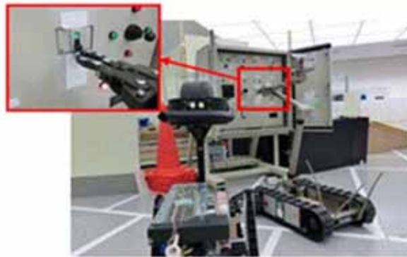
制御盤を開放しスイッチ操作
