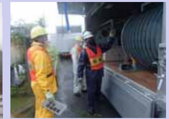
降雨時の電源車の設置・運用
