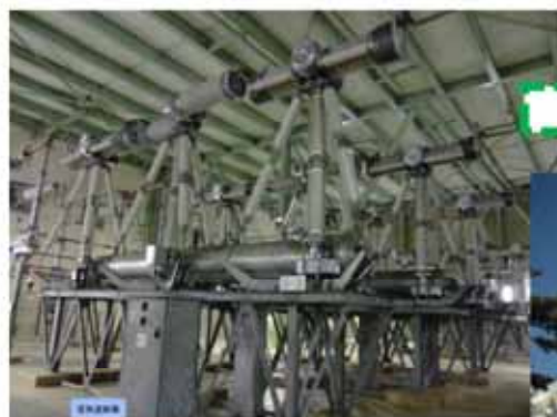
気中開閉所(取替前)
