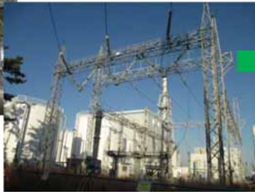
気中開閉所(取替前)
