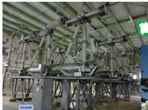
気中開閉所(取替前)
