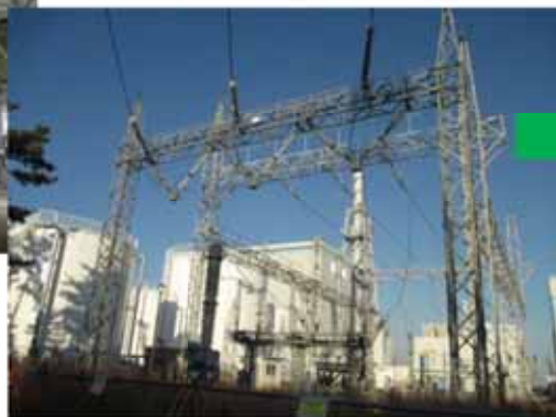
気中開閉所(取替前)
