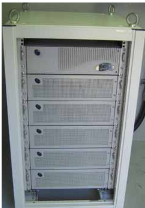
無停電電源装置
