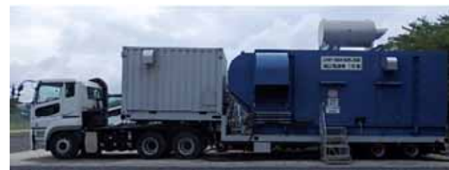
常設代替交流電源設備
