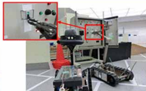
制御盤を開放しスイッチ操作
