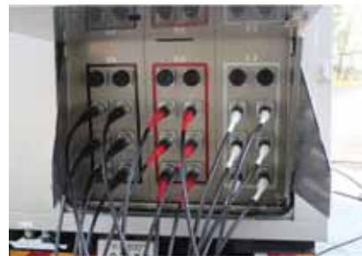
ケーブル接続箇所(低圧電源車)
