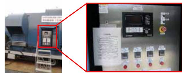
現場操作盤 (高圧電源装置)
