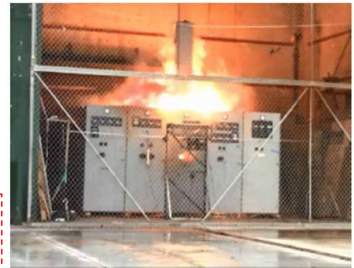
HEAF試験 高圧電源盤のアーク放電・火災発生状況
