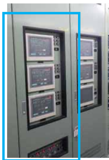
当該制御盤外観
