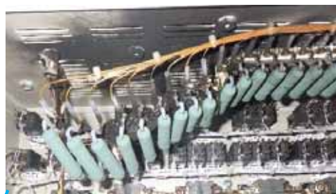
当該制御盤内
