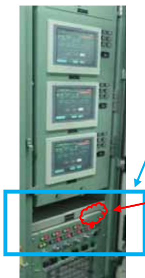
当該制御盤外観（外扉内）
