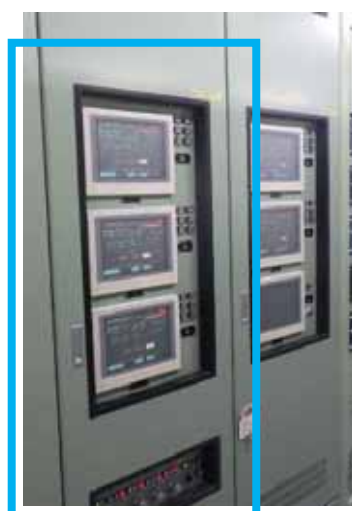
当該制御盤外観
