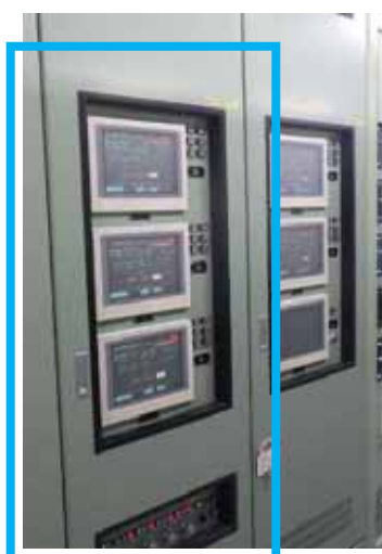
当該制御盤外観
