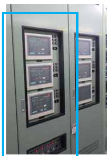
当該制御盤外観
