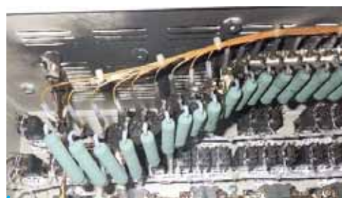
当該制御盤内
