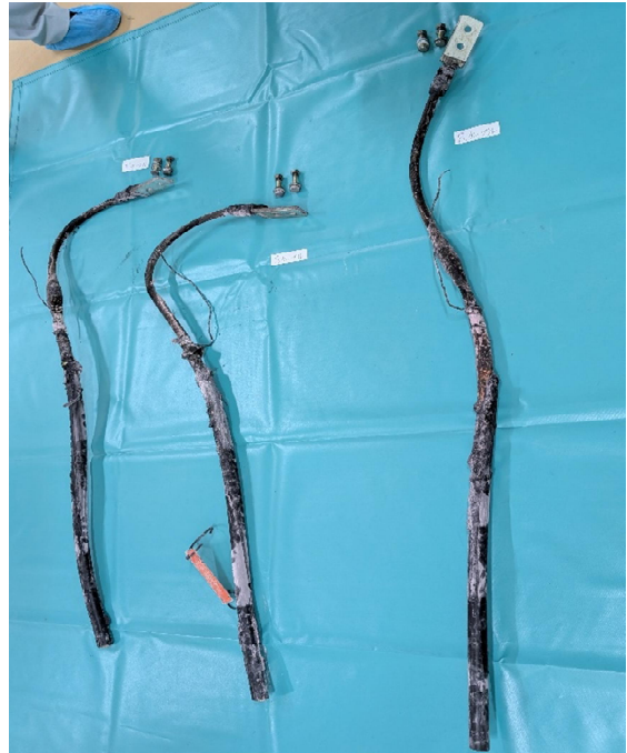
高圧配電盤内から取り外したケーブル
