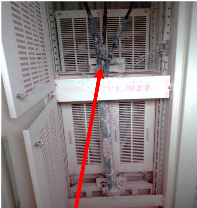
出火した高圧配電盤内ケーブル (盤背面) ピンク色の付着物は消火剤である
