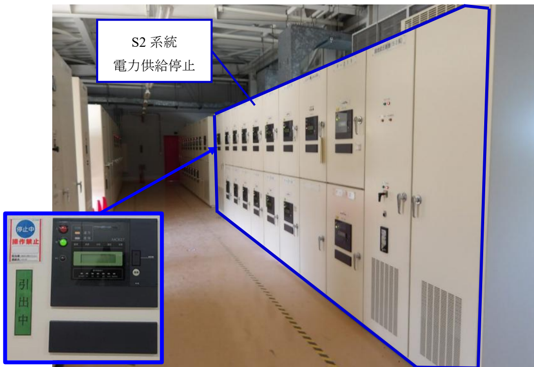
遮断器「切（緑点灯）」状態
