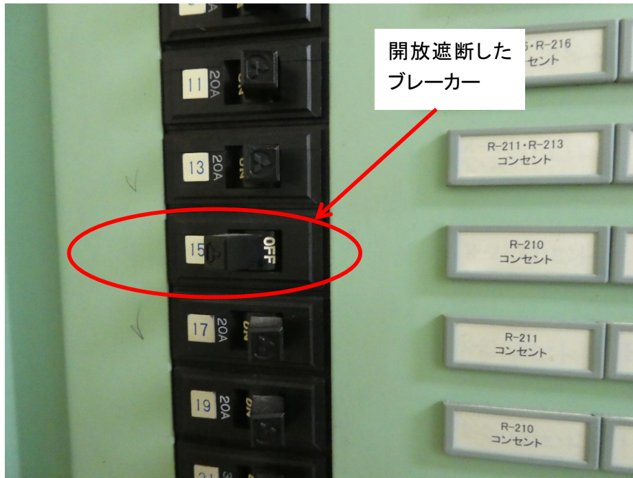
ブレーカーの開放遮断後
