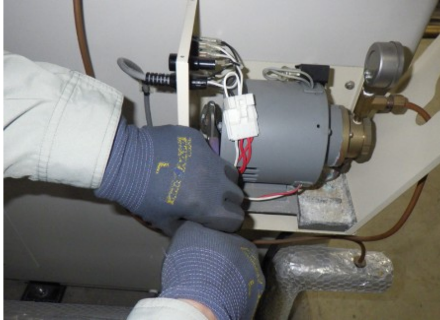
【当該加湿器電動機（A C－ 4）の手回し確認】
