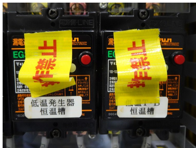
写真 4-5 同一仕様の恒温槽の主電源ブレーカー断の状況
