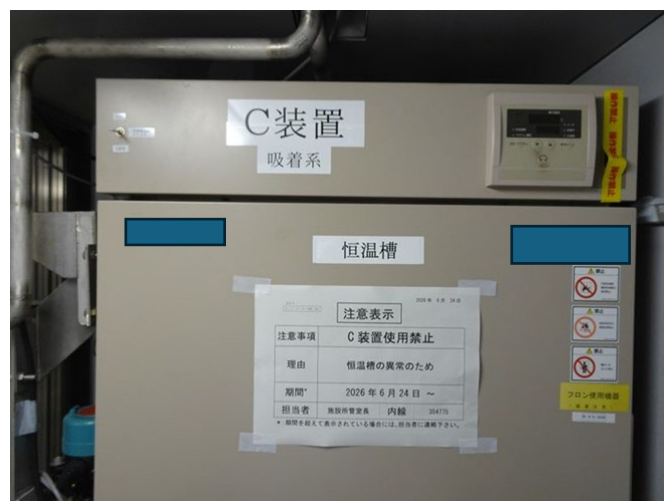
写真 4-6 同一仕様の恒温槽の使用禁止表示の状況
