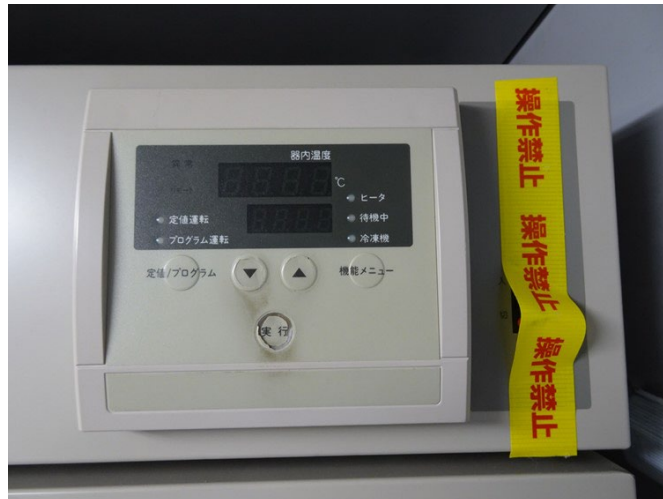
写真 4-4 同一仕様の恒温槽のコントローラ電源スイッチ電源断の状況
