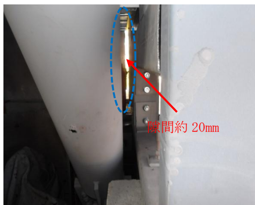
屋外へ火花が飛んだと考えられる隙間
