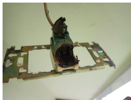
照明スイッチ焦げ跡
