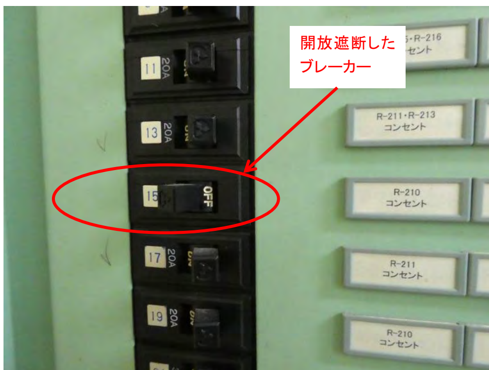
ブレーカーの開放遮断後
