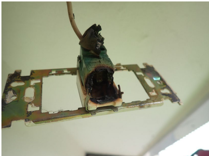
図3 照明スイッチの外観（上）と内部の焦げ跡状況（下）
