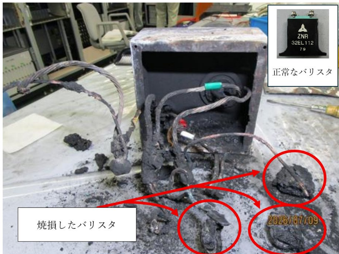
図6 電源ケーブル収納ボックスから引き出されたケーブル配線
