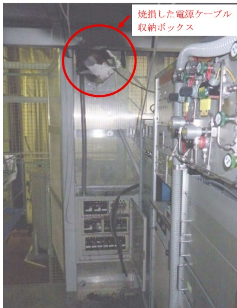
図3 焼損した電源ケーブル収納ボックスの周辺の状況
