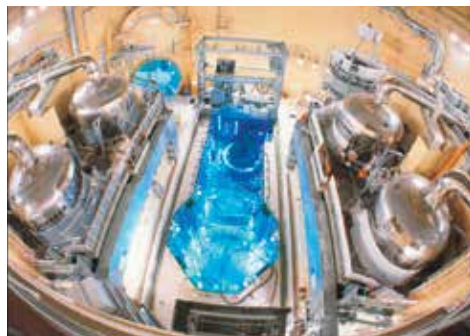
原電敦賀2号機（PWR）蒸気発生器
