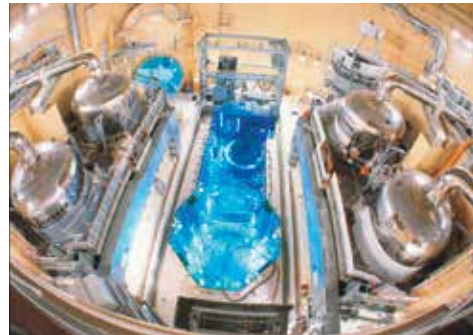
原電敦賀2号機（PWR）蒸気発生器
