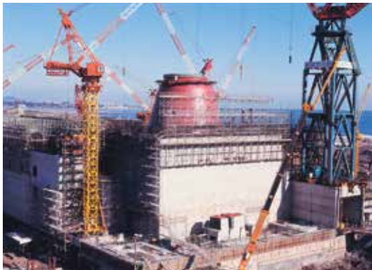
東海第二発電所原子炉格納容器（原電）
