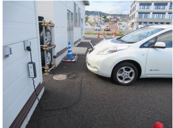
公用車EVと普通充電器
