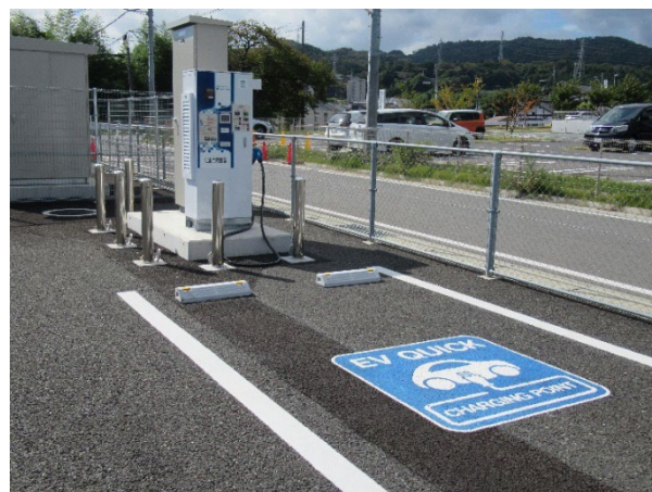
高圧受電設備と急速充電器の設置
