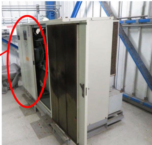
空気圧縮機外観
