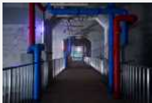
霞ヶ浦導水那珂機場 (水戸市)
