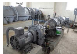
用排水ポンプ設備
