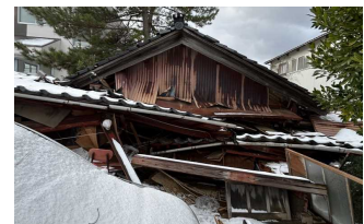
地震による木造住宅の被害
