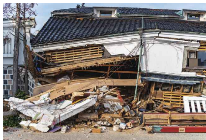
地震による被害例 (能登半島地震)
