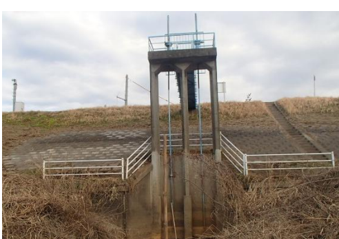
新堀揚水機場地区 (下妻市) H28~R1
