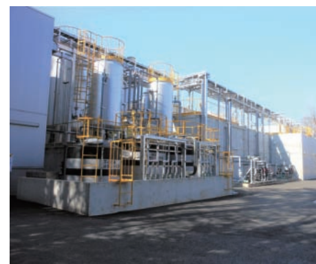
排水処理施設
