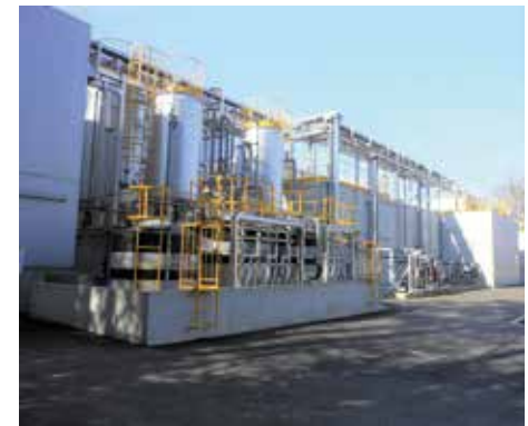
排水処理施設
