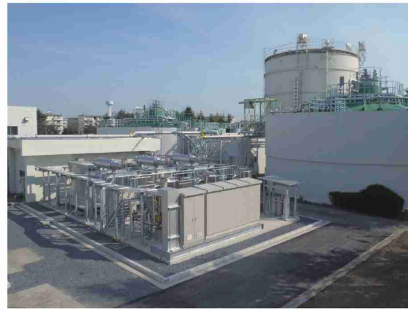
水戸市浄化センター消化ガス発電施設 (単独公共下水道)
