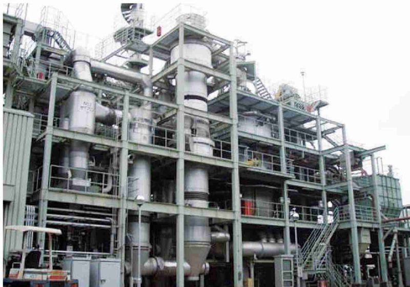
広域汚泥 1号焼却炉
