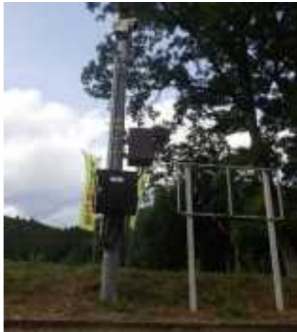
監視カメラ (CCTV)
