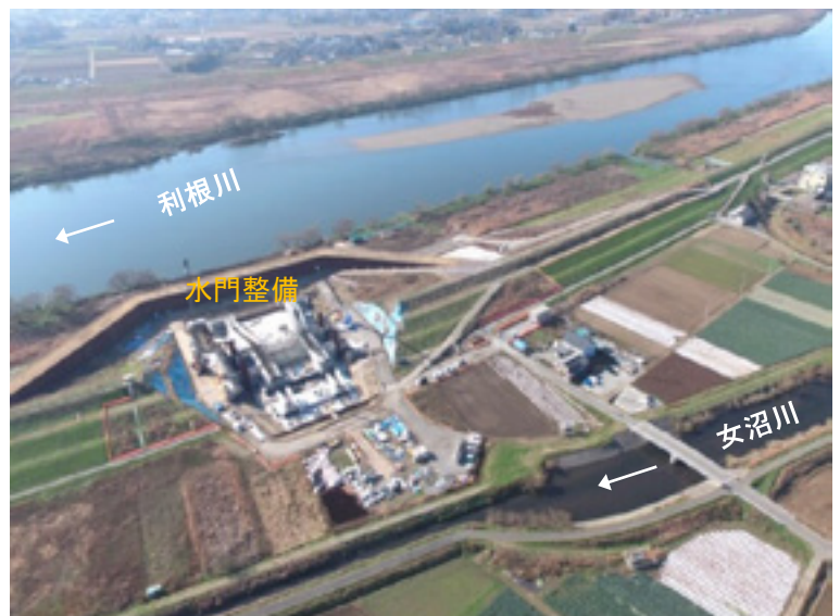
一級河川 利根川の河川改修工事 (古河市、国土交通省施工) ▶
