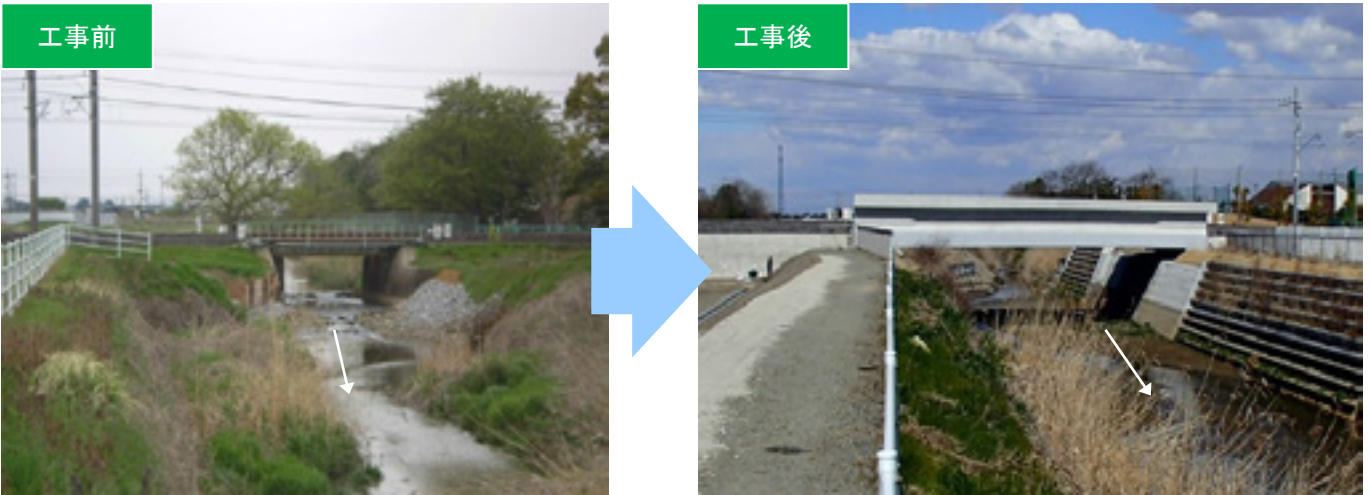
▲一級河川 相野谷川の河川改修工事(取手市、茨城県・JR施工)
