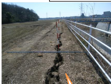
被災状況写真
