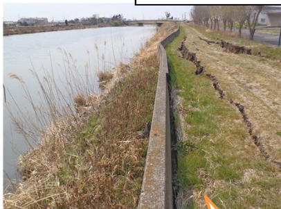
被災状況写真
