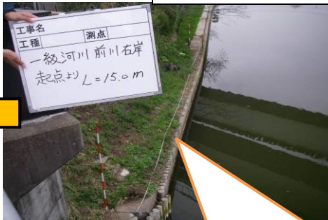
被災状況写真
