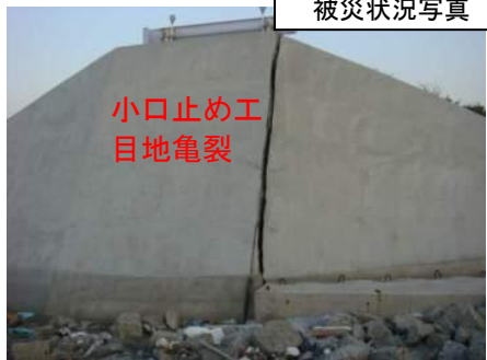
被災状況写真
