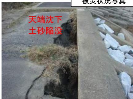
被災状況写真
