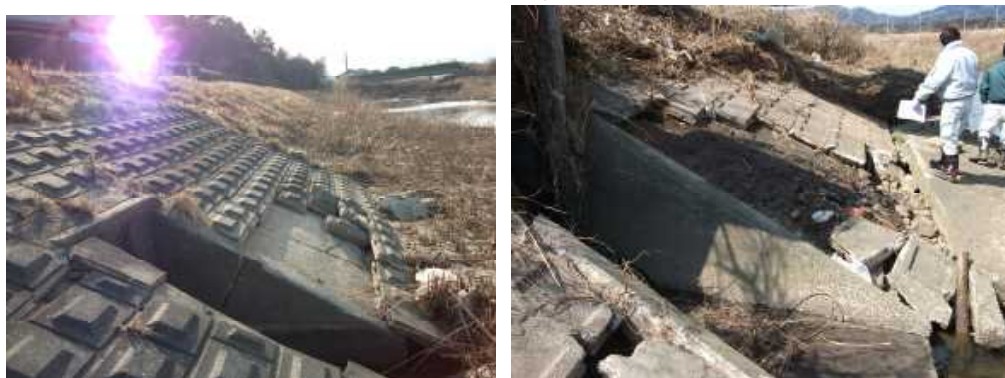
図1-10(2) 津波により被災した護岸
