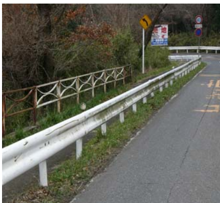
汚れが付着したままの道路構造物
