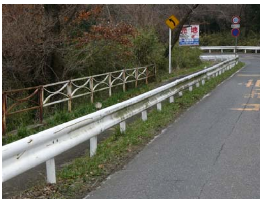
汚れが付着したままの道路構造物
