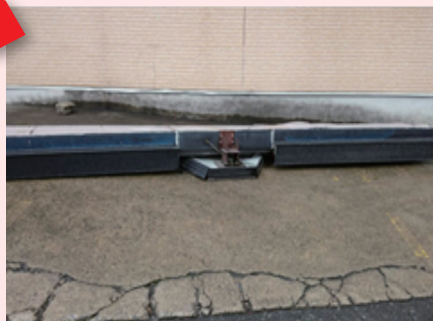
落下した欄間看板
