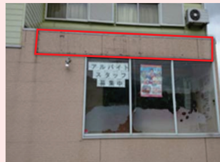
落下した後の壁面
