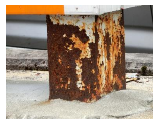
支柱根元の腐食が進行した状態
