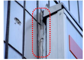
コーキングが劣化した状態
