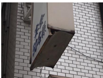
その他 (塗装剥離、腐食など)
