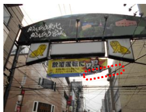
幕材を張る部材が破損した 状態
