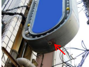
水抜き孔が詰まった状態
