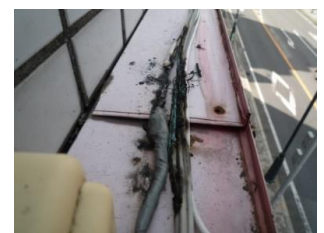
配線が劣化し、ショートした状態
