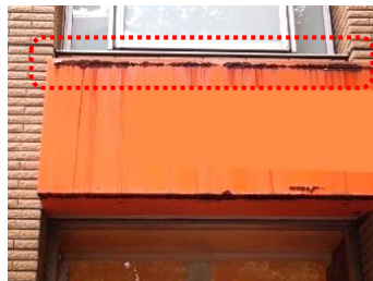
その他（塗装剥離、腐食など）
