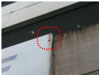
金具が劣化した状態
