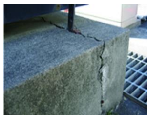
基礎にクラックが入った状態
