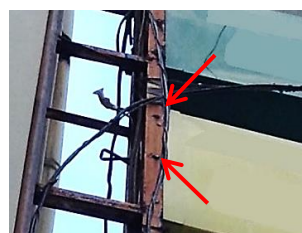
ボルトのゆるみや欠落した状態
