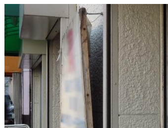
壁面との間に隙間が生じた状態
