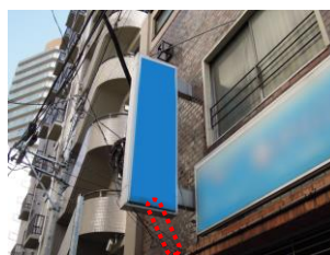
振れ止め棒が変形した状態
