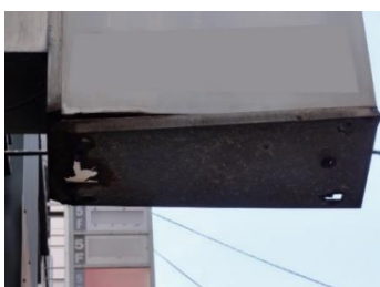
側板・表示面板押さえの変形・破損・部材の欠落
