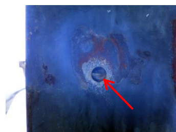
水抜き孔の詰まり
