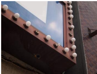
ランプ球が破損した状態
