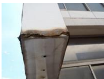
広告板底部の腐食
