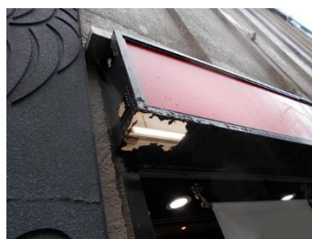
側板底面の腐食が進行した状態
