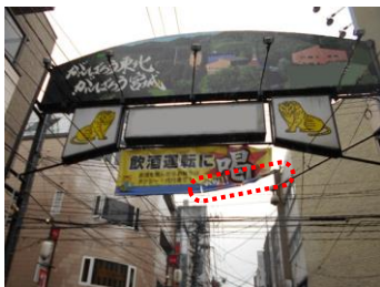
幕材を張る部材が破損した状態
