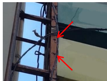
ボルトのゆるみや欠落した状態
