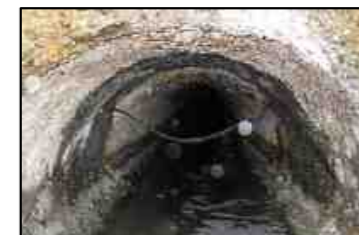
写真 6 腐食進行後の管渠の状況
