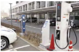
普及が望まれる電気自動車充電設備(つくば市役所：つくば市提供)
