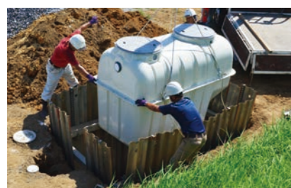
○泳げる霞ヶ浦を目指した取組(浄化槽の設置)
