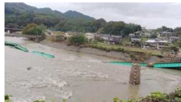
▲ J R水郡線の橋梁の流失
