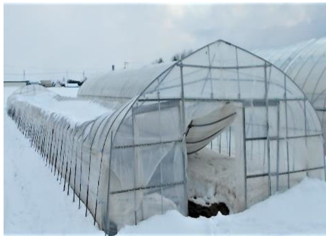
雪による被害の様子
