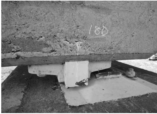
国道293号里川橋被害状況
