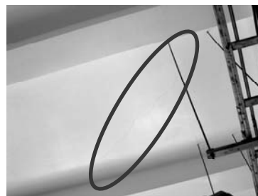
4階イルカホールディングプール天井クラック
