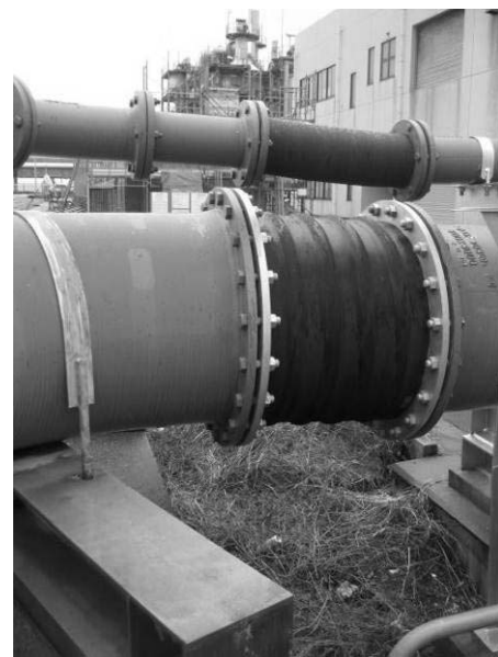
A系返送汚泥配管破損復旧状況
