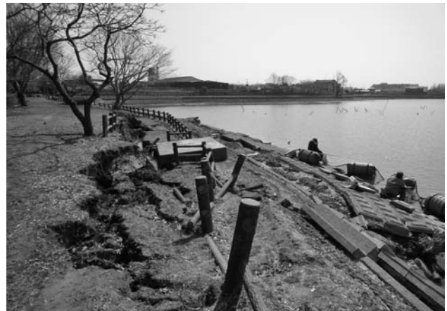
砂沼広域公園の被害状況
