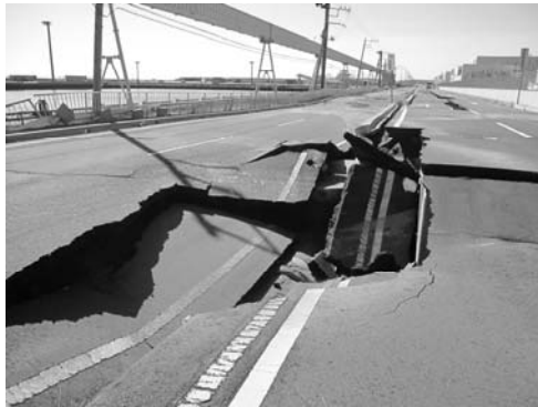
臨港道路の被害状況
