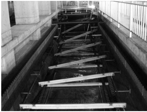
汚泥掻寄機（水処理施設最終沈殿地）
