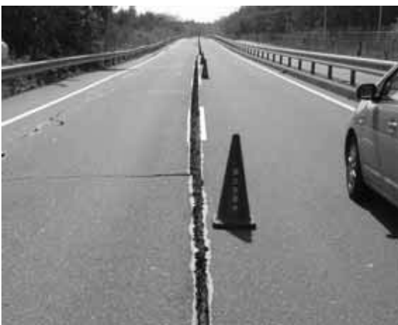
国道51号大洗町成田町周辺被害状況
