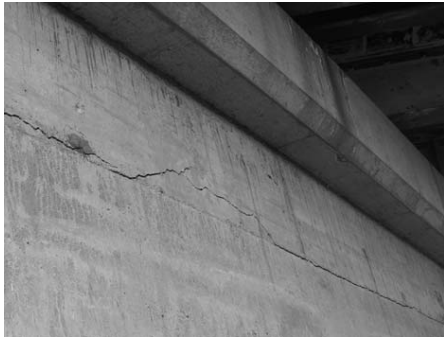
国道118号静跨線橋被害状況
