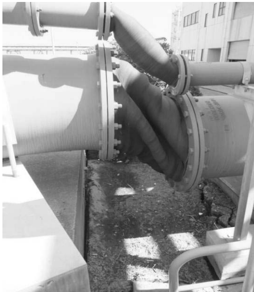
A系返送汚泥配管破損被害状況
