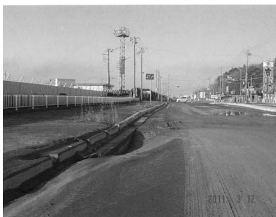
国道 245 号日立市みなと町周辺被害状況
