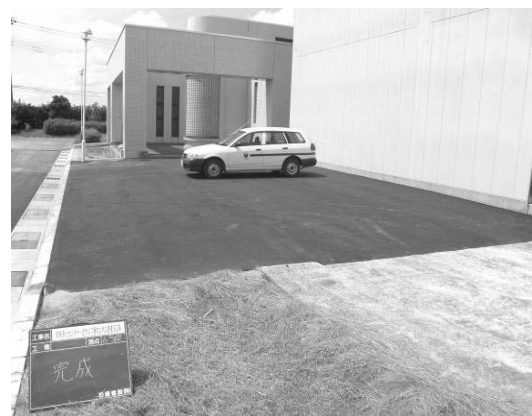
液状化（場内管理用道路）応急復旧状況
