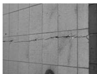
県西生涯学習センター：床タイルの亀裂
