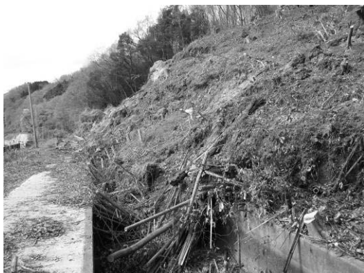
常陸太田市：辰ノ口堰幹線用水路 約1,000haの用水供給に懸念
