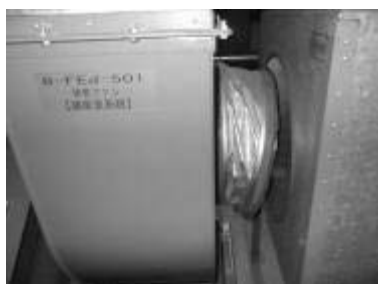
県南生涯学習センター：排気ファン脱落
