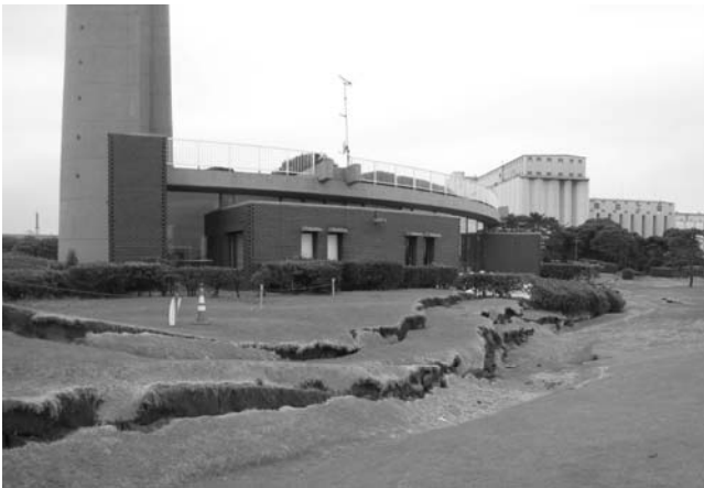
港公園の被害状況
