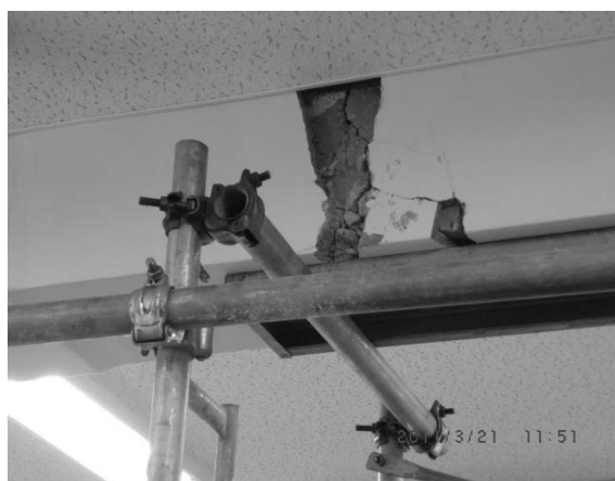
梁躯体部クラック
