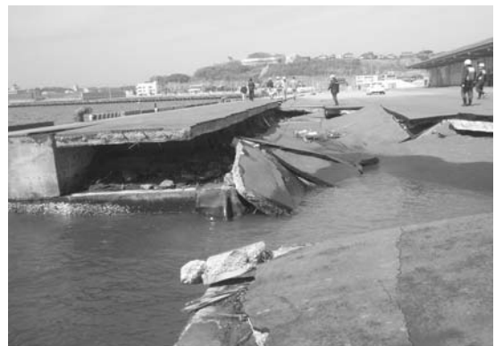
流出した第2ふ頭地区の護岸・ふ頭用地
