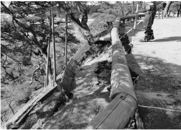
偕楽園の被害状況
