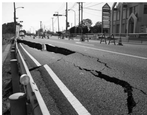
国道 245 号日立市大みか町周辺被害状況
