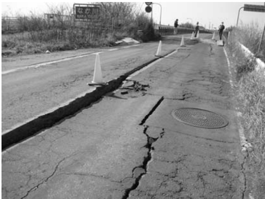
県道馬渡水戸線勝田橋被害状況
