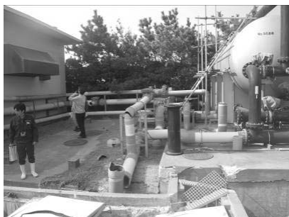
不等沈下による配管の破断
