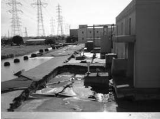
鱒川浄水場被害状況（全景）
