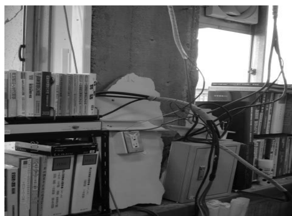
防災システム機器の脱落
