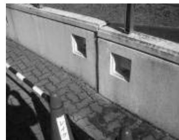
女性プラザ：擁壁の沈下
