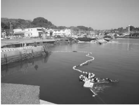
大津漁港 -5m岸壁の崩落
