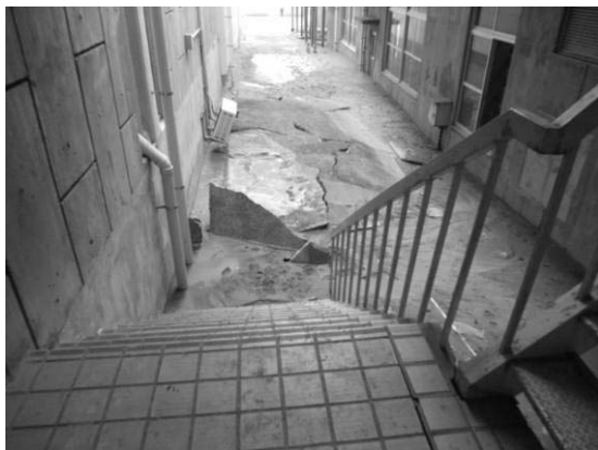
液状化（沈砂池建物周辺）被害状況
