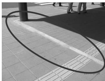
3階入り口タイルの沈下
