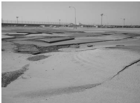
日立港区5ふ頭地区被災直後
