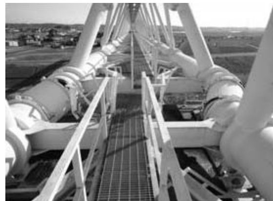
被害状況（水管橋）
