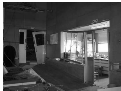
魚類棟内の損壊
