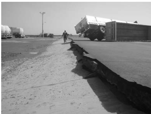
陥没した第4ふ頭地区のふ頭用地
