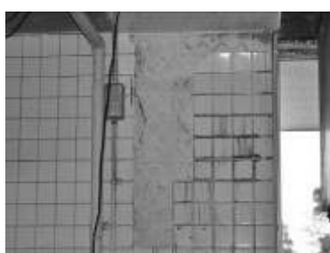
白浜少年自然の家：剥離したタイル
