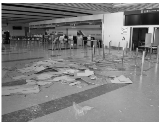
崩壊直後（1階ロビー）
