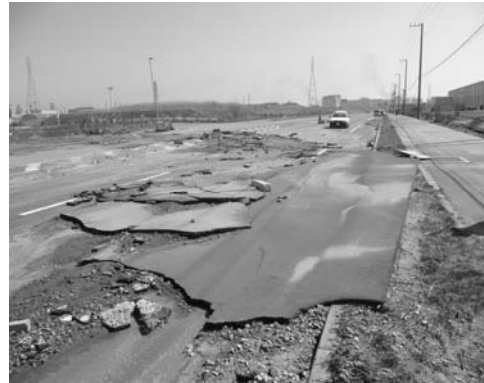
北ふ頭臨港道路の被害状況
