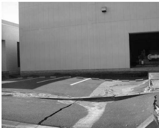
液状化（場内管理用道路）被害状況
