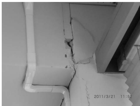
柱・梁接合部クラック
