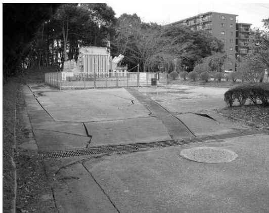
液状化した場内管理用道路被害状況
