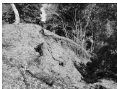
白浜少年自然の家：崩落した法面
