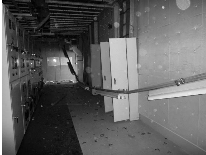
25階高圧変電設備の被害状況
