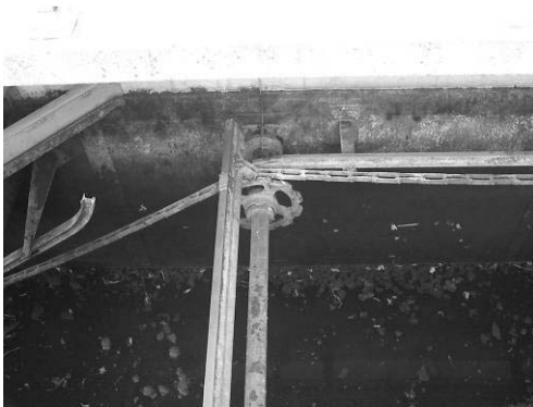
汚泥掻寄機被害状況
