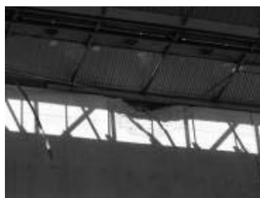
図書館：剥離した壁
