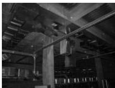
県南生涯学習センター：ダクトの脱落
