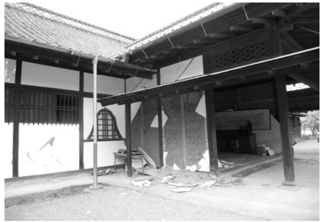
弘道館公園の被害状況
