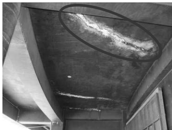
1階外部壁面クラック
