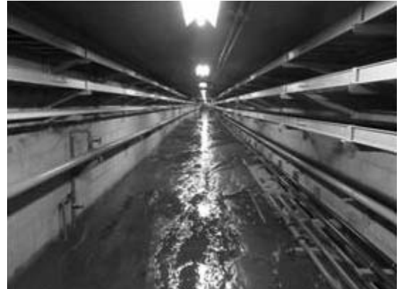
鱒川浄水場被害状況（共同溝）
