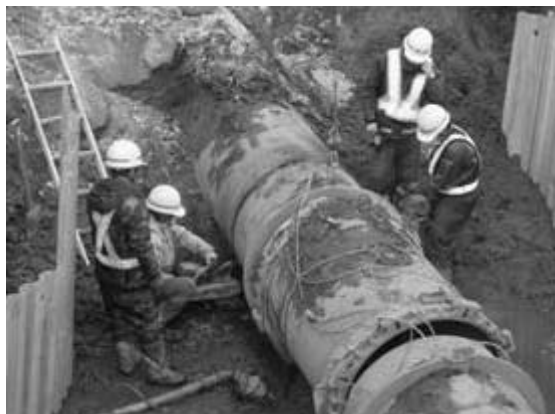
被害状況（送水管）
