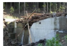
治山ダムによる流木の流出等の抑制
