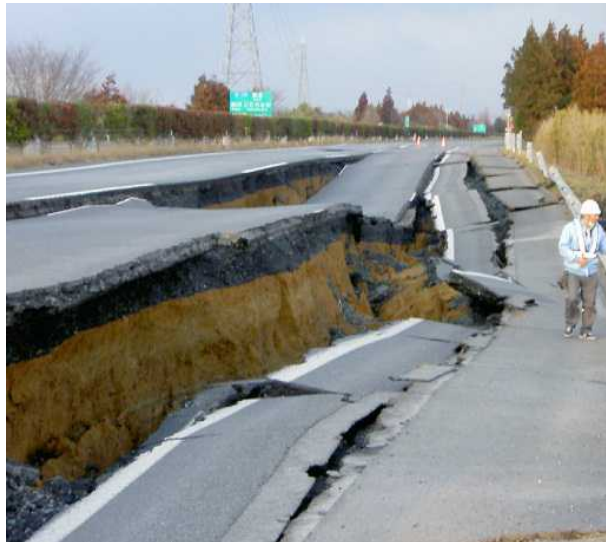
■ 東日本大震災の被害状況 路面が陥没した常磐自動車道 (水戸～那珂)
