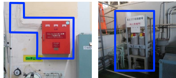
飛来物の衝突を防止する設備を設置
