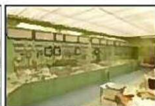
③タービン・発電機及び 所内電源系制御盤
