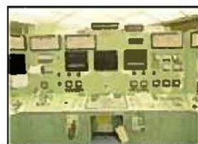
①原子炉制御盤
