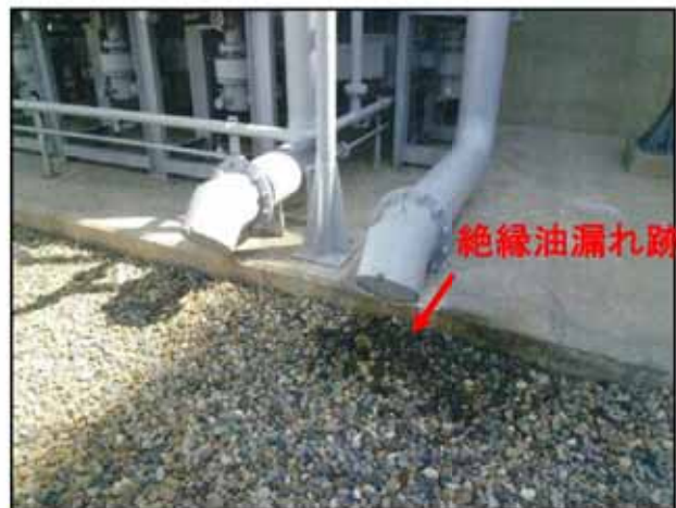
起動変圧器2A
