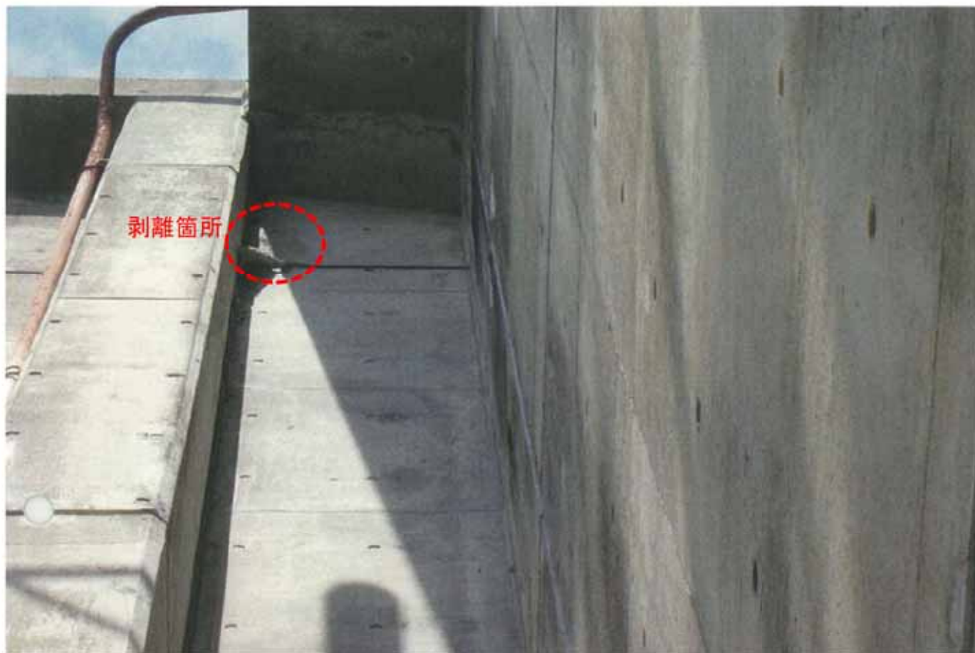
遮風壁室上部張出部のコンクリートが剥離・剥落
