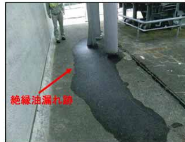
起動変圧器2B
