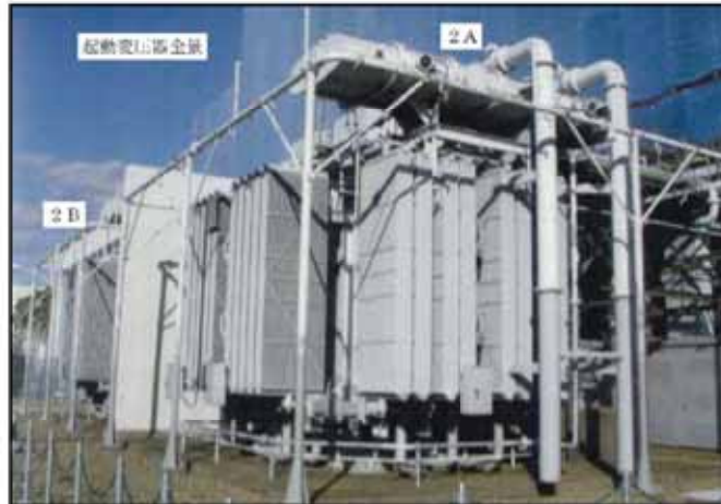
起動変圧器全景A
