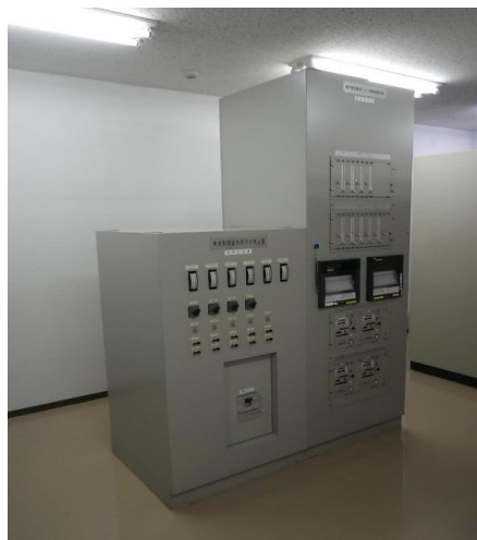
中央制御室外原子炉停止盤 (原子炉制御棟)
