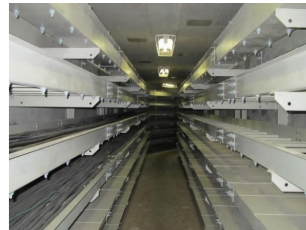
鋼材製ダクトによる ケーブル分離
