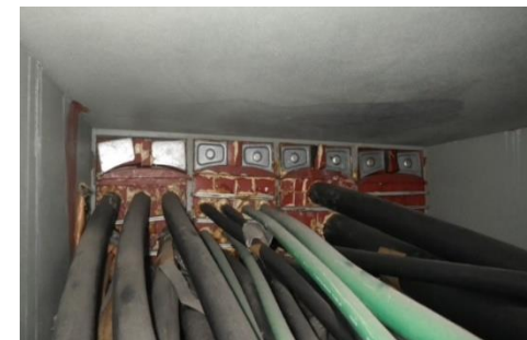
ケーブル貫通部
